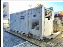
#5: Generator Cogen XFA0010
