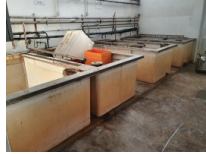
#16: N. 4 Tanques de Fibra de Vidrio
