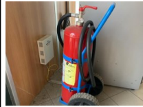
#51: N. 2 Fire Extinguishers
