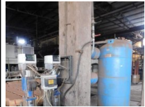
#77: N. 2 Bombas Lowara Hydrovar
