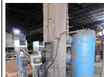
#77: N. 2 Pompe Lowara Hydrovar
