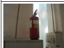
#37: N. 15 Fire extinguishers
