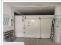
#37: N. 2 Celdas Frigoríficas e Instalación de Producción de Hielo
