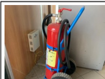
#51: N. 2 Fire Extinguishers
