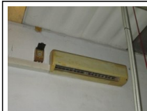
#68: N. 4 Wall Air Conditioners
