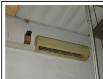
#68: N. 4 Wall Air Conditioners
